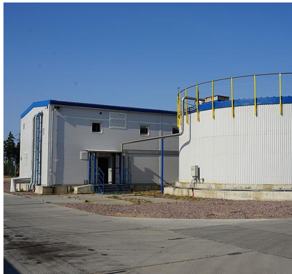
Эксплуатация комплекса очистных сооружений временного вахтового поселка Балтийский ГПЗ: КОС – 900 м3/сут, КОС – 1800 м3/сут ООО «Ренейсанс Хэви Индастрис»; КОС – 1100 м3/сут ООО «Велесстрой», п. Усть-Луга, Ленинградская область
