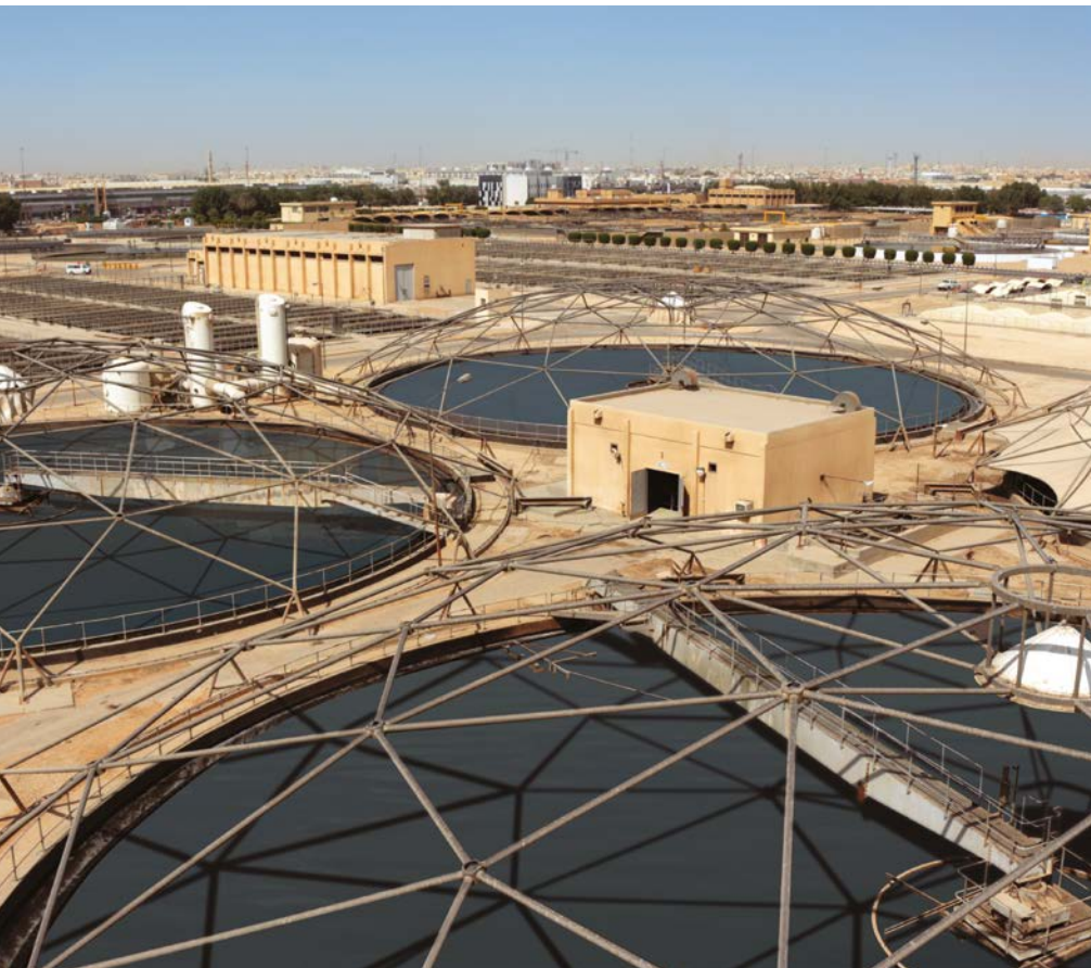
Очистные сооружения «Манфуха», производительностью 500 000 м³/сут. КСА, г. Эр-Рияд
